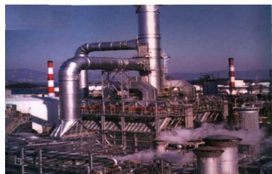
<사진 3-2> fire Heater
