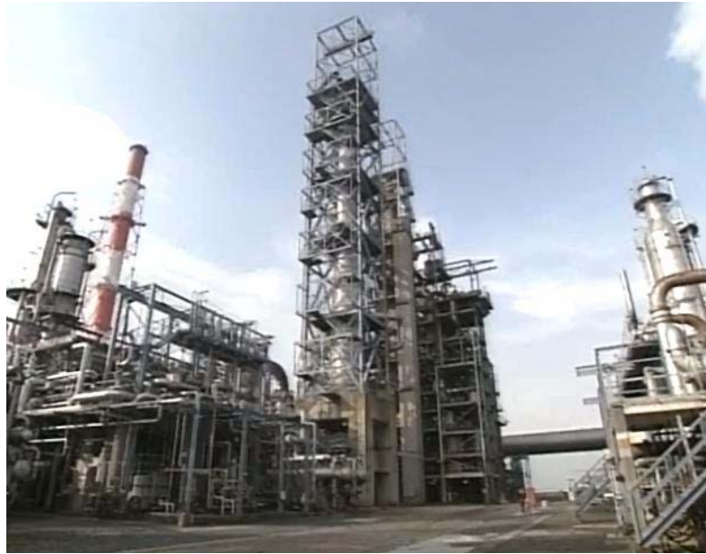
<사진 3-5> Naphtha reformer의 전경
